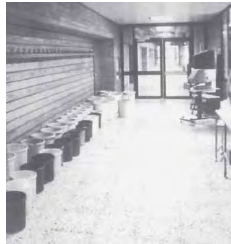
Abb.13 Wasserschäden während der 2. Erweiterung 2002
