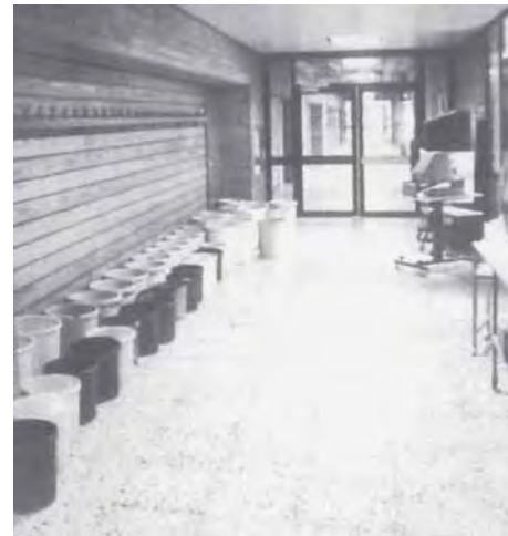
Abb.13 Wasserschäden während der 2. Erweiterung 2002
