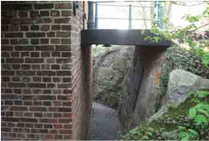
Abb. 11 Sicherung der Böschungen. Nach den Sicherungsmaßnahmen war das Gebäude wieder rundum begehbar. Quelle: Sammlung H. W. Breidenbach
