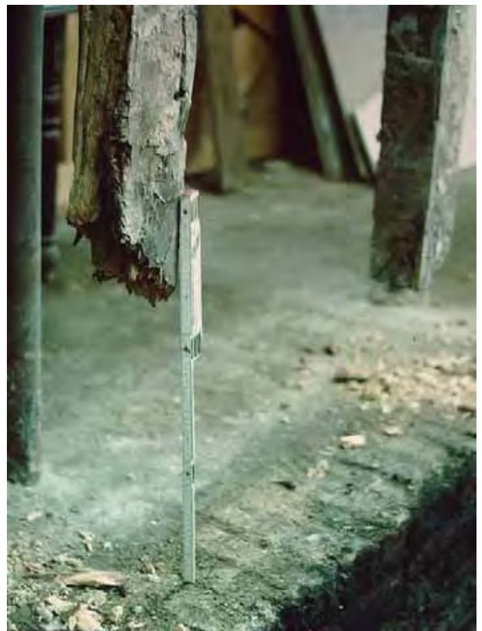
Abb. 3 Fundament mit verrotteten Fachwerkstielen am Westgiebel des Gebäudes
