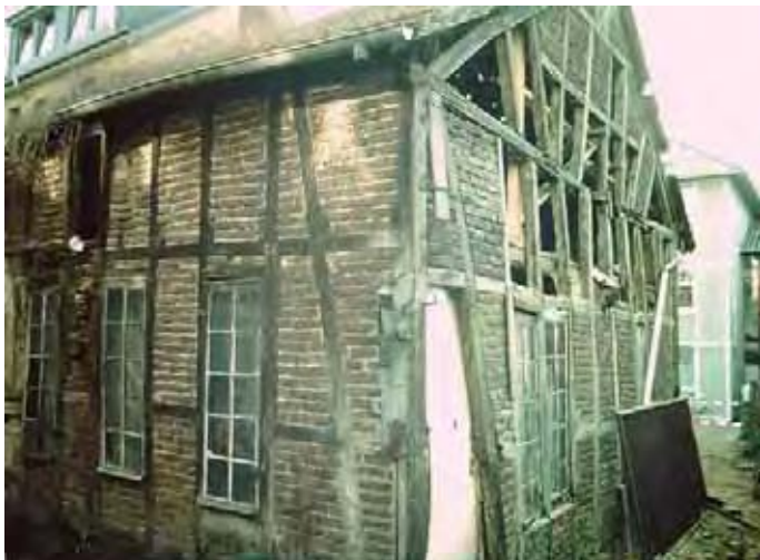
Abb. 2 Nordseite (links) und besonders stark gefährdeter Westgiebel (rechts) der ehemaligen Stellmacherei
